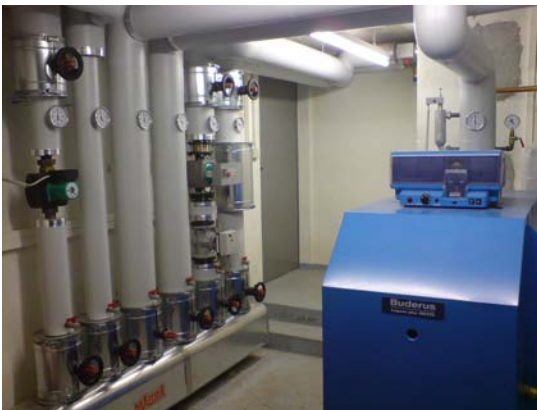
Heizungsanlagen Über dem Weiher 5/7
