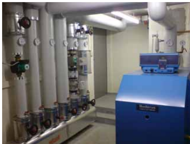
Heizungsanlagen Niddablick 11 und Berliner Straße 70-74
